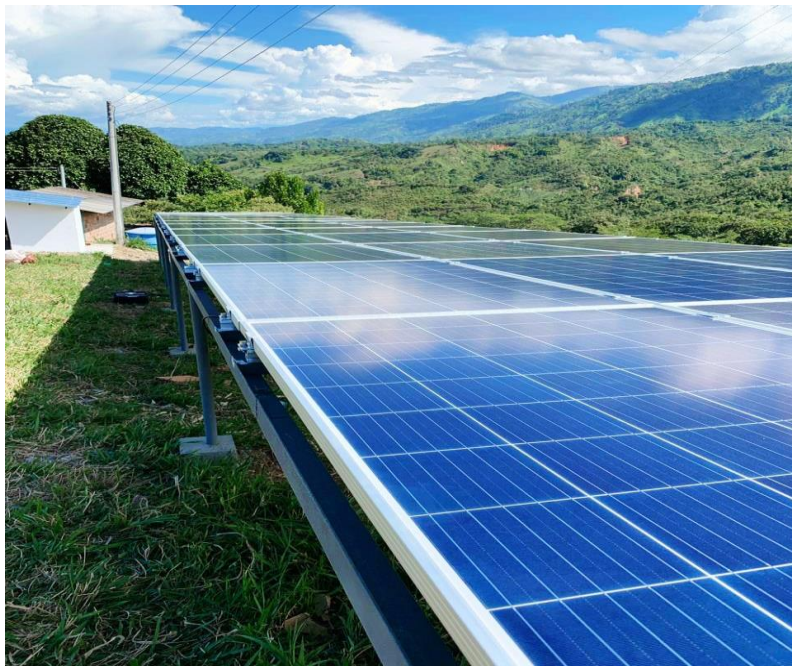
Paneles solares. Granja en Chaparral
