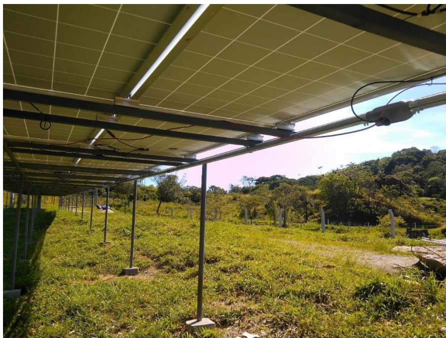
Vista inferior de paneles solares instalados en granja acuícola en Lérida
