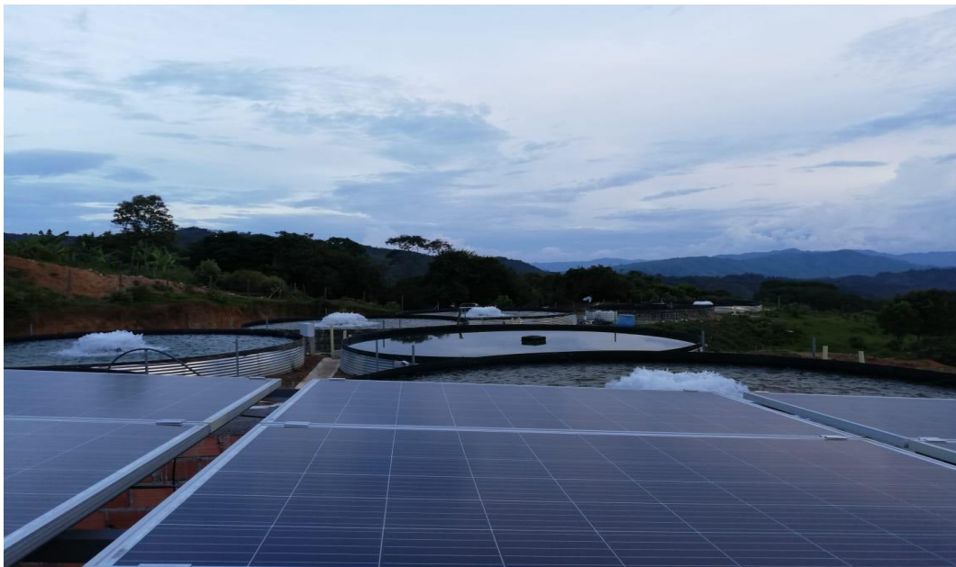
Paneles generadores de la energía fotovoltaica
